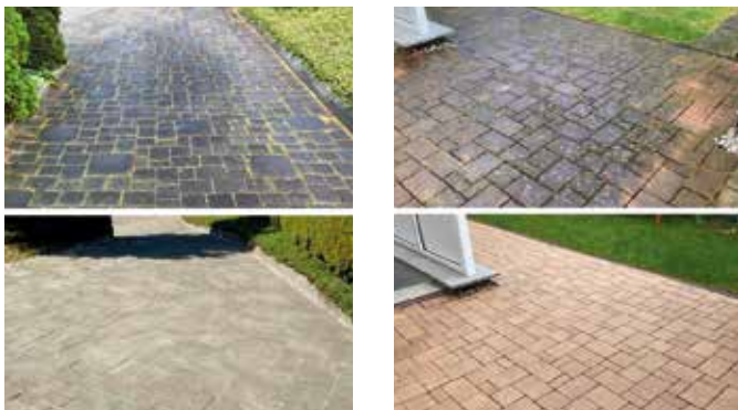
Zwei Steinflächen jeweils vor (oben) und nach der Sanierung (unten) (Foto: MH Stone)
